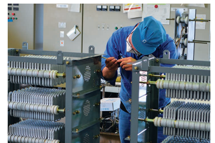
抵抗器の組立工程の様子
