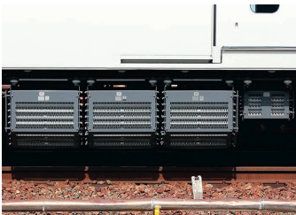
車両と線路の間に抵抗器が搭載される
