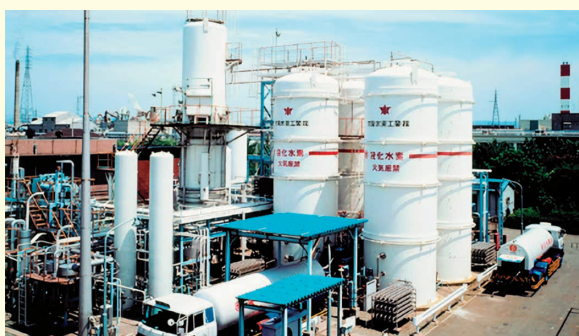
日本初、大型商用液化水素製造プラント
